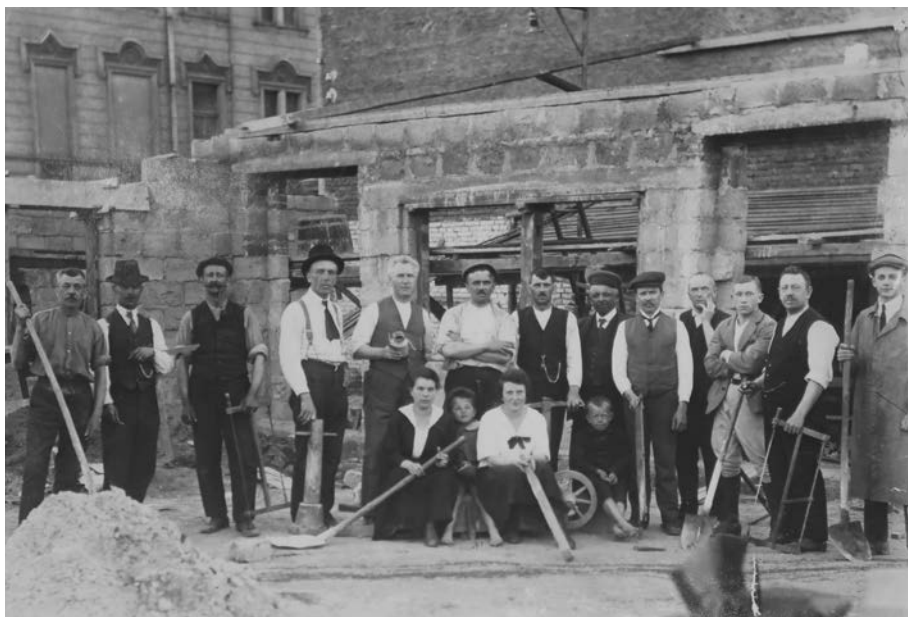
Snímek z budování sokolského domu Bouda v roce 1921 v místech po levé straně školy na Nedvěďově náměstí, vedle dnešních schodů do ulice Na Dolínách.
