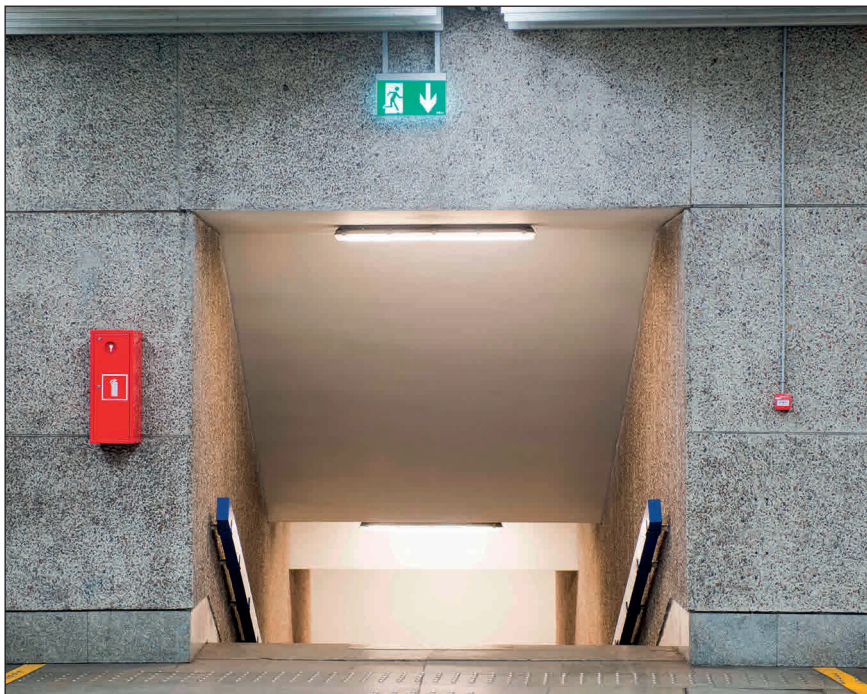
Obr. 4 Kvalitní značení směru úniku umožňuje rychlé opuštění budovy
