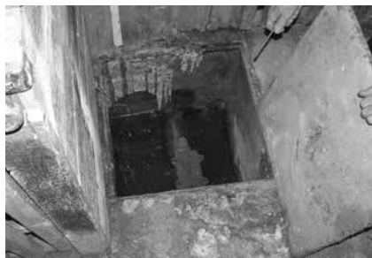
Obr. 2.2 Vysoká hladina podzemní vody v revizní šachtě vnitřní kanalizace
